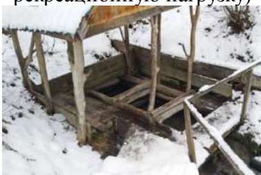
г. Дятьково (днище балки)
